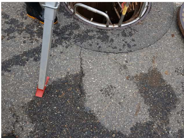
내용 포장부 아스콘 균열
