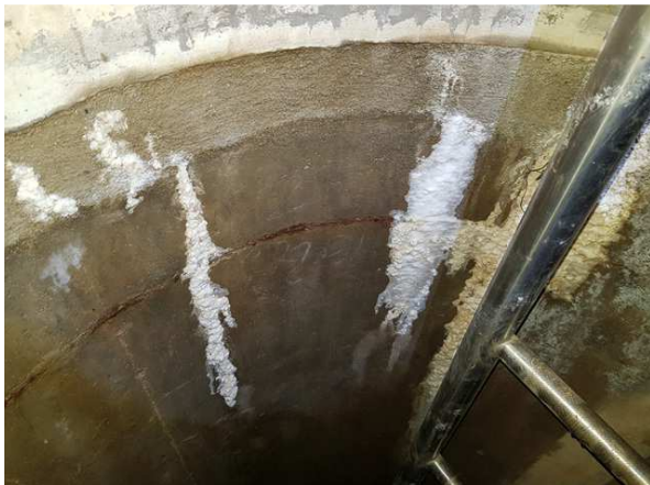
내용 맨홀 수직부 내부 벽체 백태
