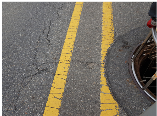
내용 포장부 아스콘 균열
